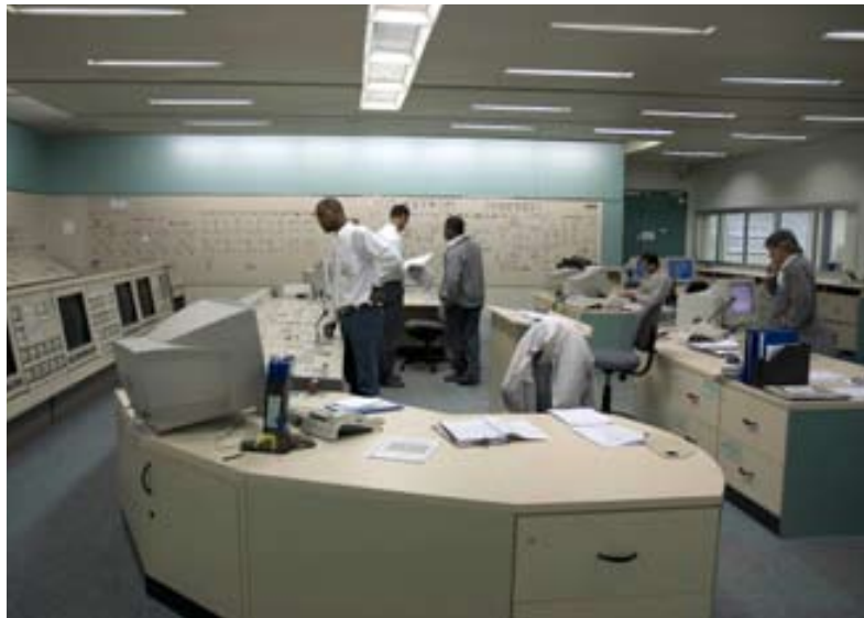
Sala de Controle - Angra 2
